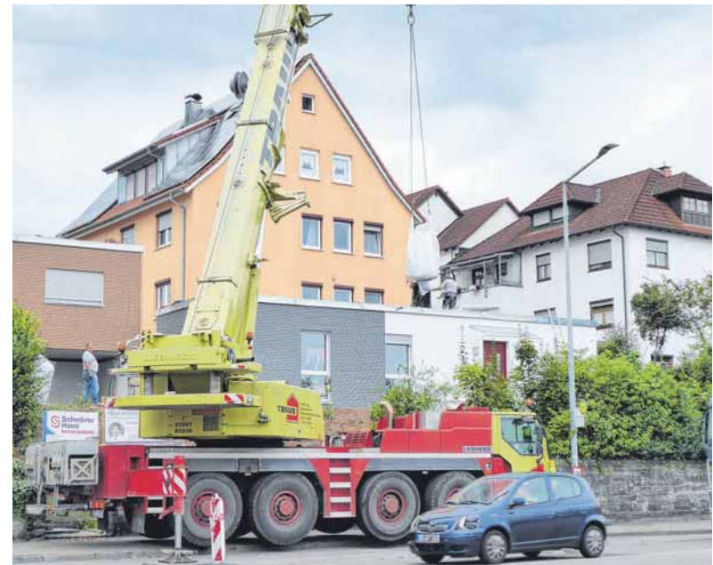
Mit dem Autokran sind Erde und Pflanzen für die Dachbegrünung aufs Haus der BigFam in der Haller Straße gehievt worden.
