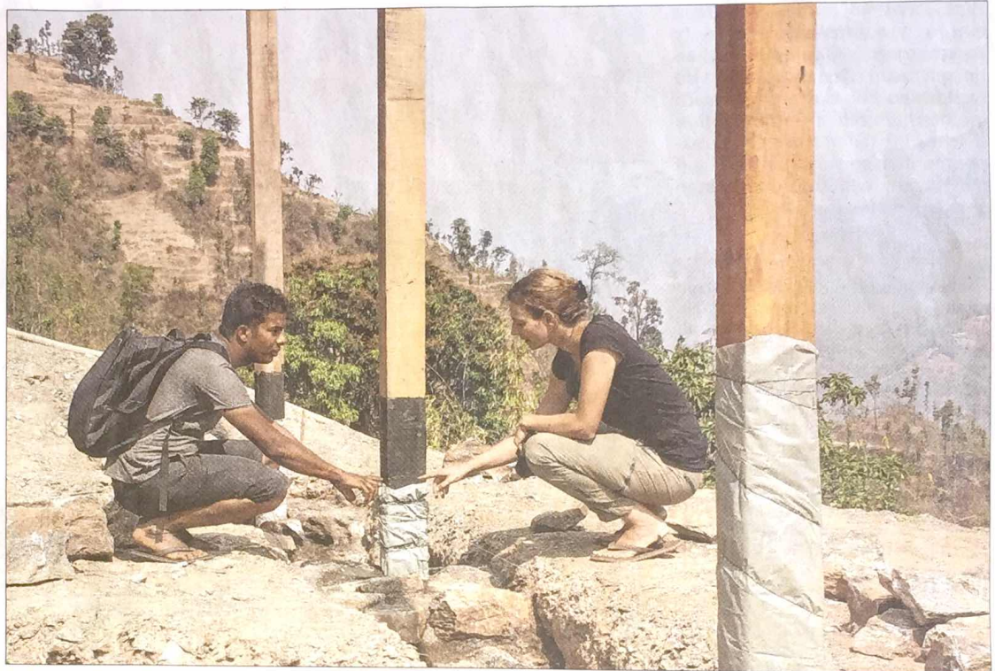
Auf dieser Baustelle in Dekhari, einem Bergdorf in dem Distrikt Makwanpur, hat Architektin Carola Peschl mit nepalesischen Ingenieuren erdbebensichere neue Häuser errichtet. (Fotos: privat)
