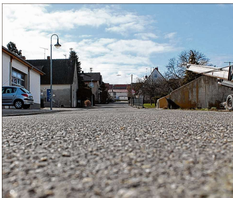
Fabrik- und Steigackerstraße in Gussenstadt sollen für mehr als eine halbe Millionen Euro saniert und ausgebaut werden. Foto: Karin Lorenz
